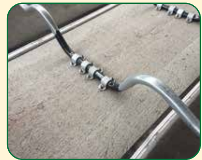
Mittels verstärkten Vollschellen direkt am Boden befestigt
